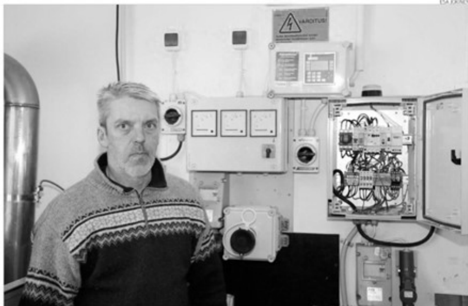
Koiviston vesihuolto-osuuskunnan puheenjohtaja Matti Friman käy silloin tällöin katsomassa jätvesipumppaamon ohjauskeskuksen tilannetta Vesiosuuskuntien huoltopalveluiden tiloissa.
