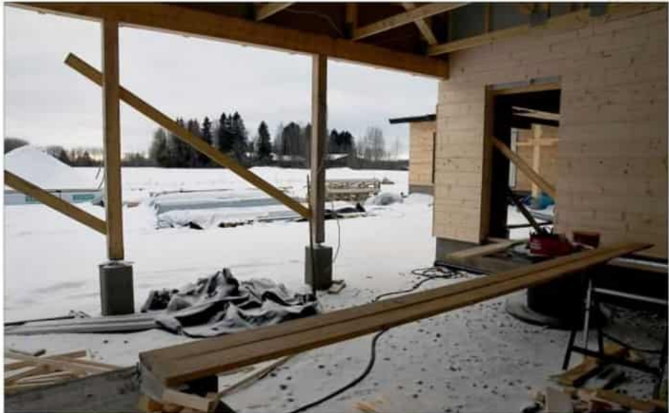
Koko Kurikassa on tonttikampanjassa lähes 150 tonttia satasen hintaan maaliskuussa. Kiven alueelle rakennettiin viime vuonna eniten Kurikassa. Kuvassa Heidi Vähämäen ja Joonas Mäkiläin rakennusprojekti Harjakoskenrallilla. Tavoitteena on muutto uuteen kotiin kesän korvalla.
